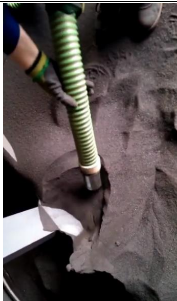
Рис.6 Уборка угольной пыли, пылесосом, на тепловых электростанциях.
